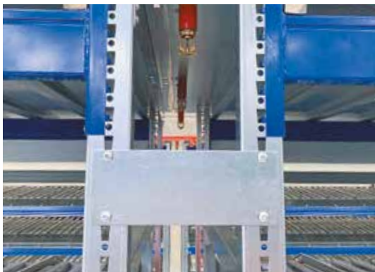
Querschacht als Teil des Löschanlagenkonzepts
